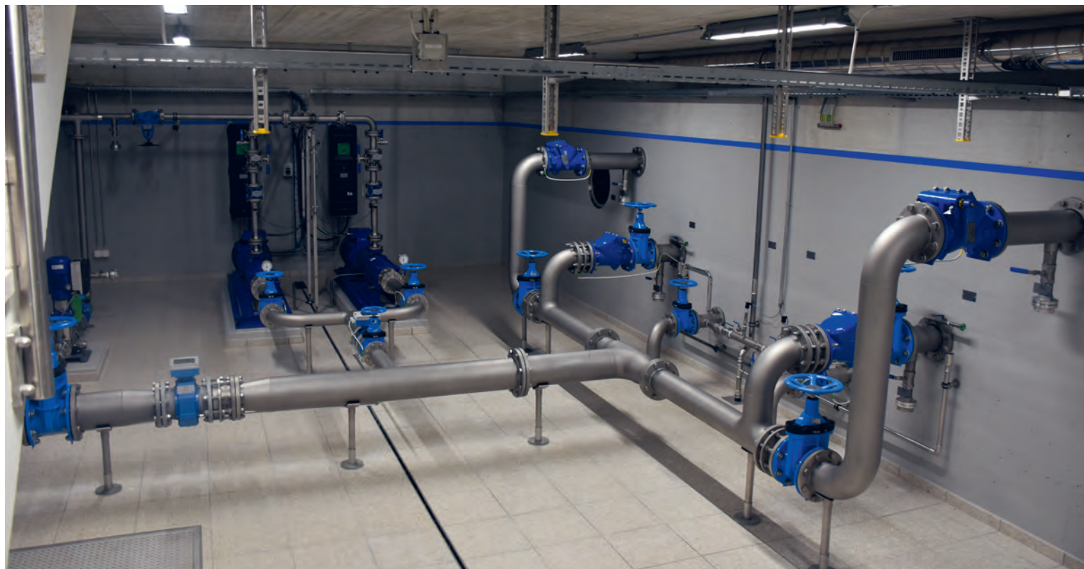
Foto 2: Ein Blick in das komplizierte «Innenleben des Reservoirs Webernhüsli.
